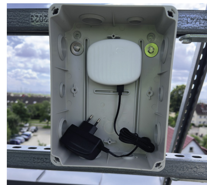
Das Gateway ist vorbereitet für den Stromanschluss durch den Elektriker.
